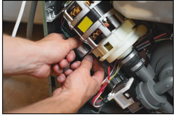
Görsel 4.30: Arızalı su pompa motoru
