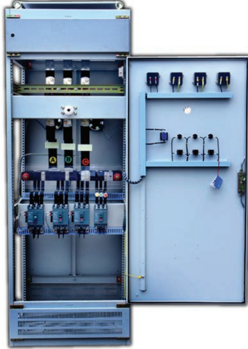
Görsel 6.23: Ana dağıtım panosu
