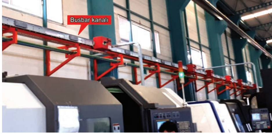
Görsel 3.4: Busbar kanalları
