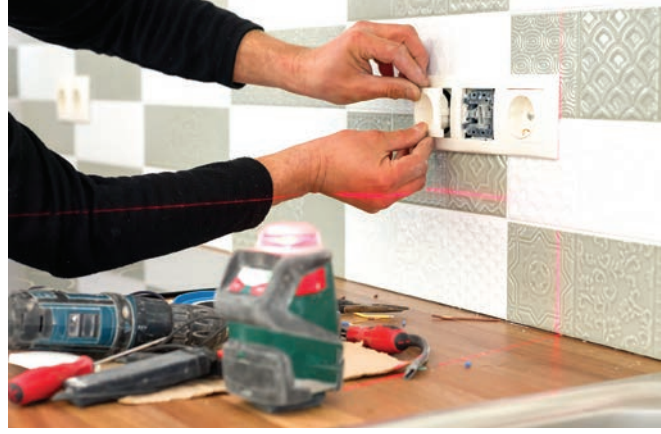
Görsel 2.40: Sıva altı tesisat
