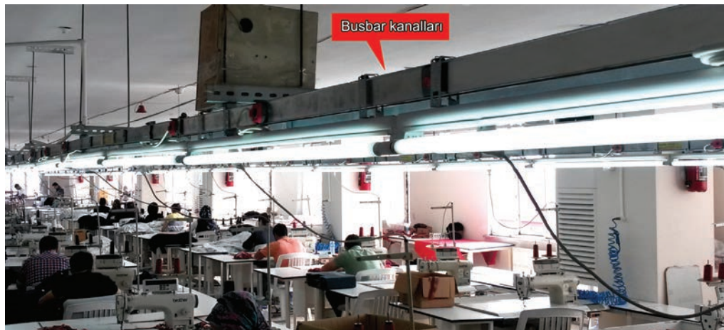
Görsel 3.5: Bir atölyenin busbar sistemi
