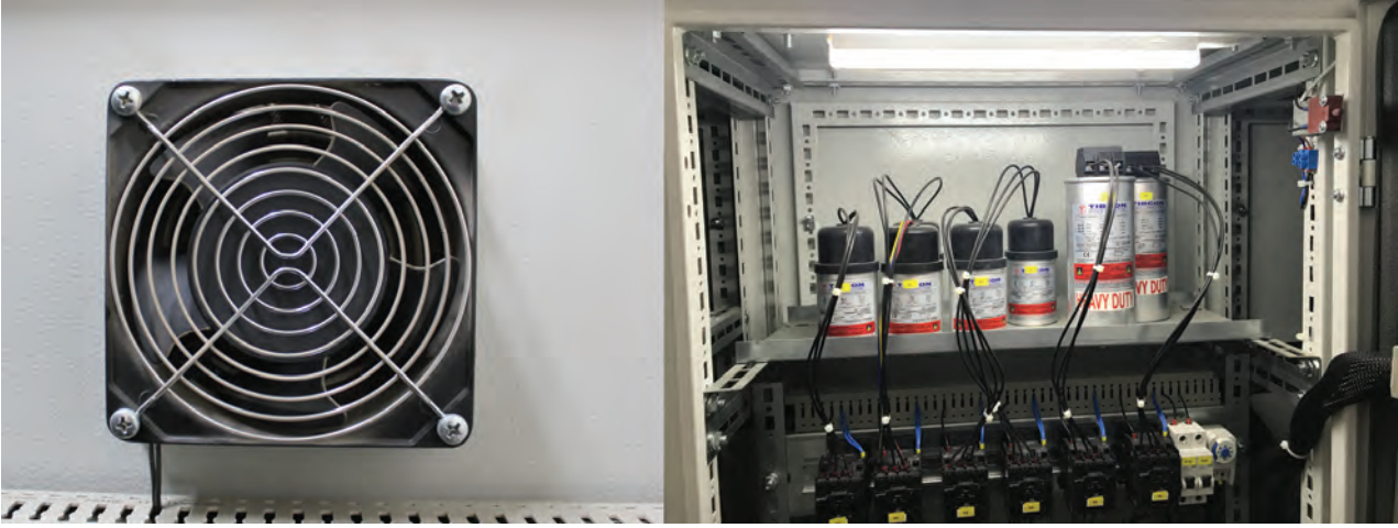
Görsel 11.11: Kompanzasyon panolarında aydınlatma ve havalandırma
