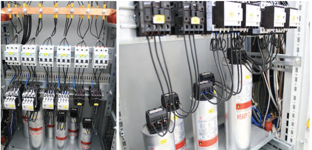
Görsel 11.7: Kompanzasyon panolarında kondansatörlerin bağlantısı
