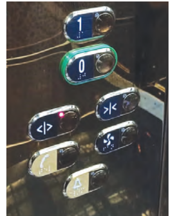
Görsel 11.73: Acil aydınlatma ve alarm
