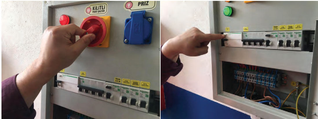
Görsel 12.15: Asansöre enerji verilmesi ve kaçak akım rölesinin kontrolü
