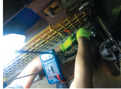
Görsel 12.11: Regülatör gergi kasnağının kontrolü
