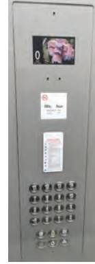
Görsel 11.61: Kabin butonu
