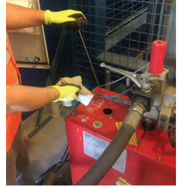
Görsel 2.7: Hidrolik yağ seviyesinin kontrolü
