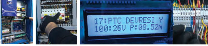
Görsel 2.23: Kumanda panosunun bakımı ve onarımı
