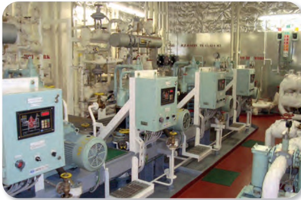
Görsel 3.79: Yakıt pompaları
