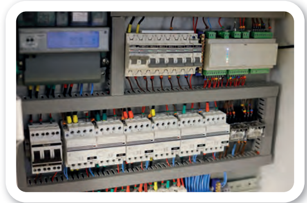
Görsel 17.13: Güç tesisatı elemanlarının bulunduğu bir pano
