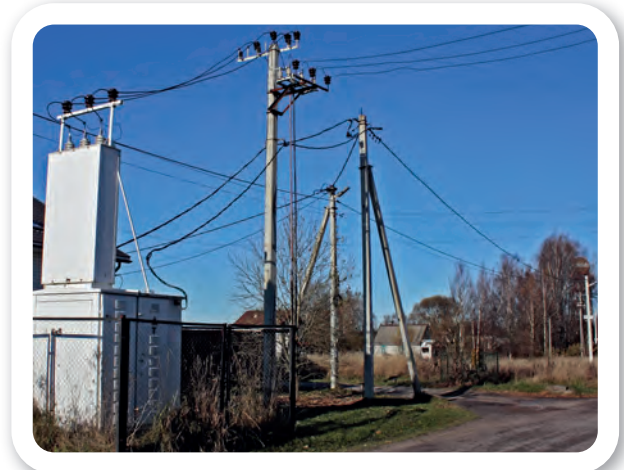
Görsel 18.2: Şehir şebeke elektrik dağıtımında kullanılan trafolar
