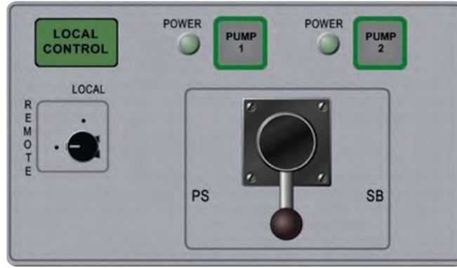
Şekil 2.12: Dümen dairesi kontrol panosu
