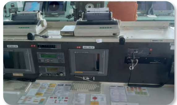
Görsel 1.71: Telsiz kamarası
