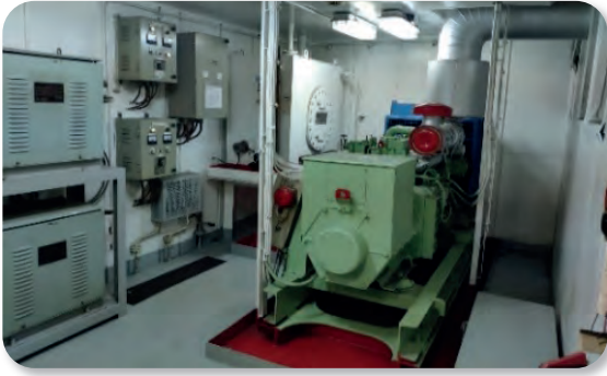
Görsel 1.40: Acil durum jeneratör odası
