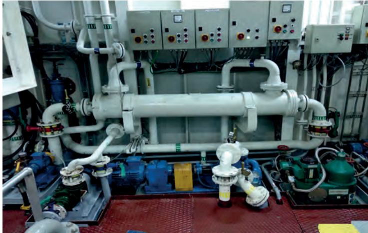
Görsel 2.22: Soğutma suyu sıcaklık ve basınç takibi
