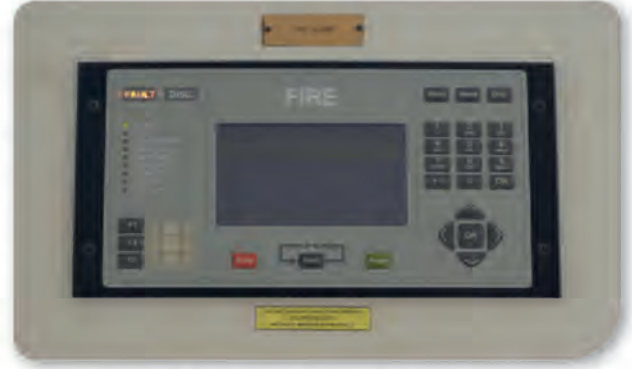
Görsel 3.2: Yangın alarm kontrol paneli
