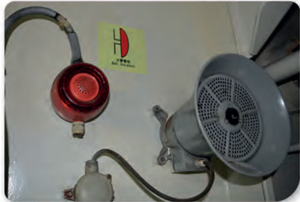
Görsel 3.5: Alarm sireni
