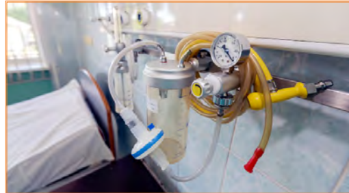
Görsel 7.7: Merkezî aspiratör sistemi vakum jakı ve göstergesi
