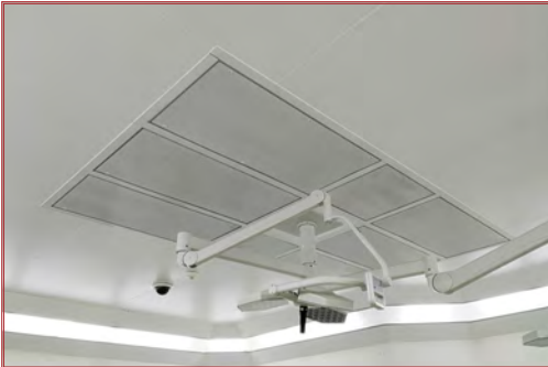
Görsel 1.4: Ameliyathane tavanında bulunan HEPA filtre
