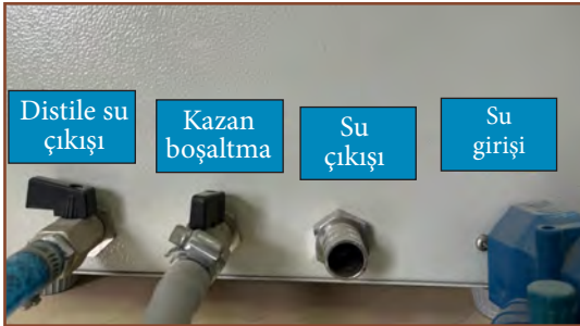
Görsel 4.4: Cihazın üzerindeki su tesisat bağlantıları
