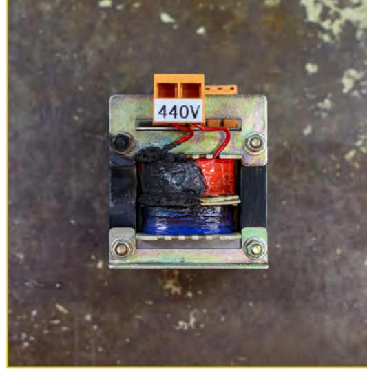
Görsel 5.8: Yanmış transformatör
