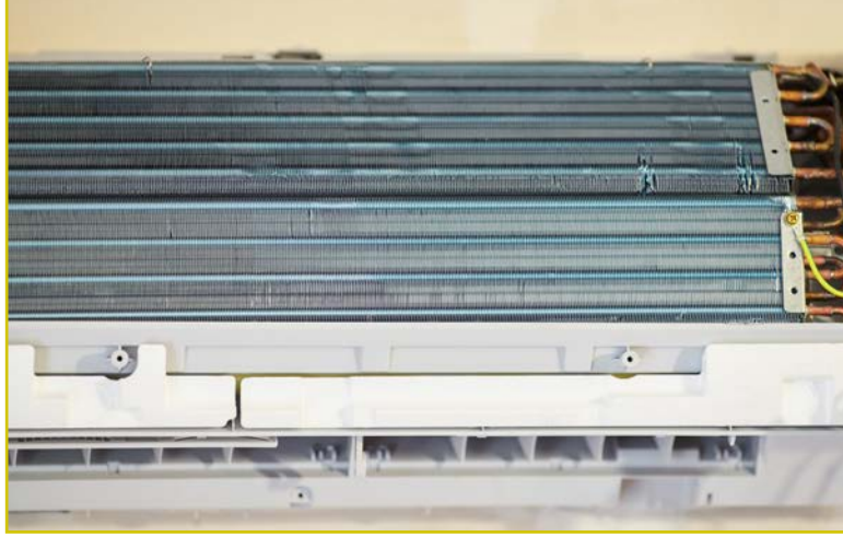
Görsel 6.3: Buzdolabındaki evaporatör tüpler
