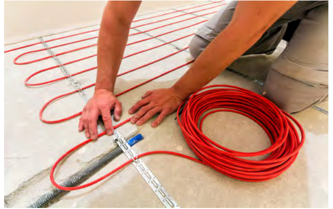
Görsel 5.4: Zemine döşenen elektrik sistemi
