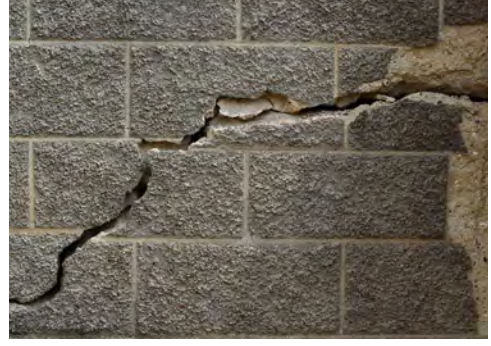
Görsel 6.12: Deprem sonrası oluşan maddi zarar
