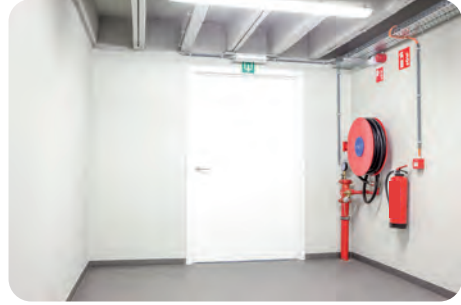
Görsel 1.6: Depoda bulunan yangın ekipmanı
