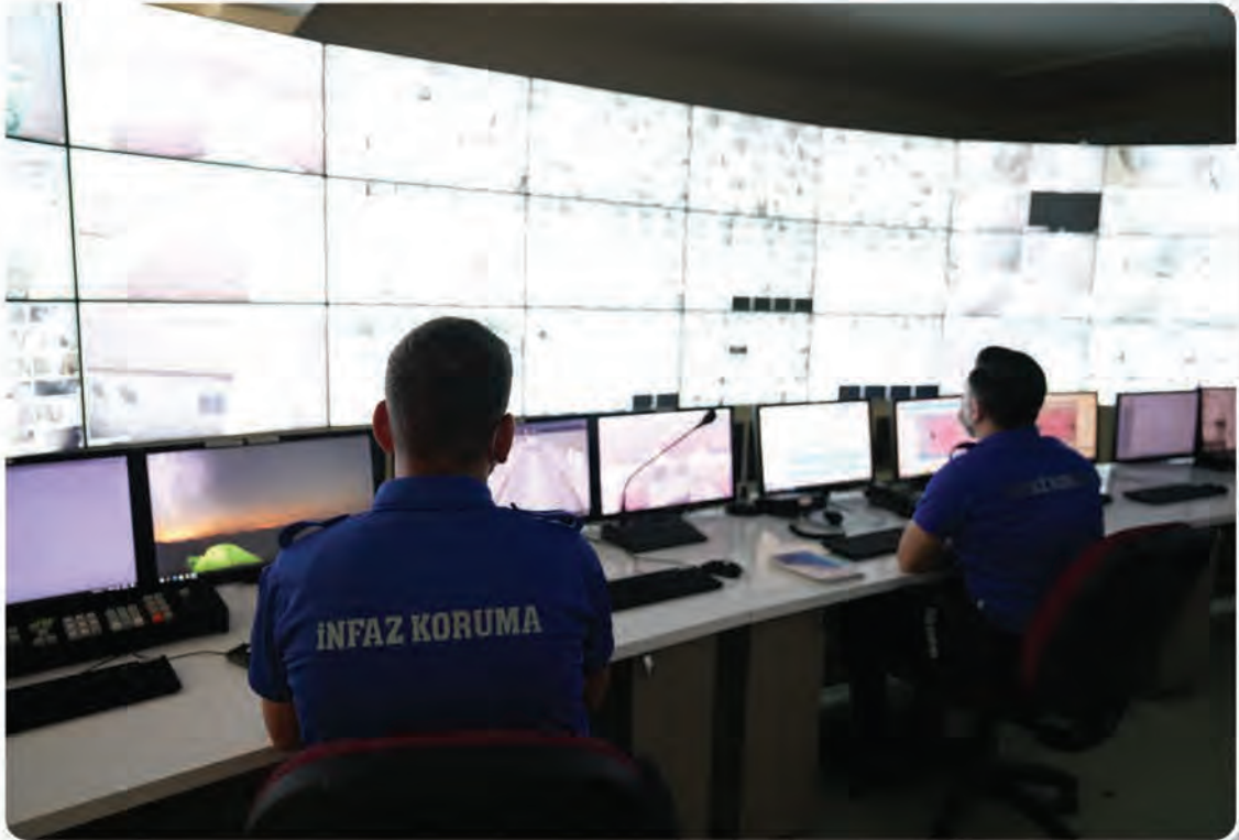
Görsel 1.1: Kontrol merkezi ve monitör izleme odası
