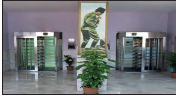
Görsel 1.39: Turnike sistemli kapılar
