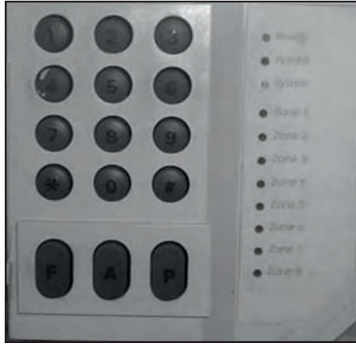
Görsel 1.12: Alarm kontrol panelleri
