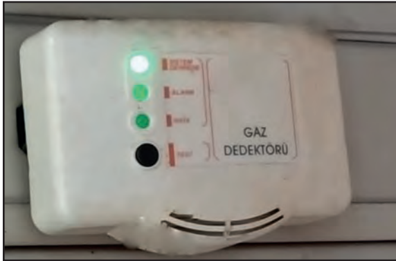
Görsel 1.16: Yangın alarm paneline bağlı gaz dedektörü
