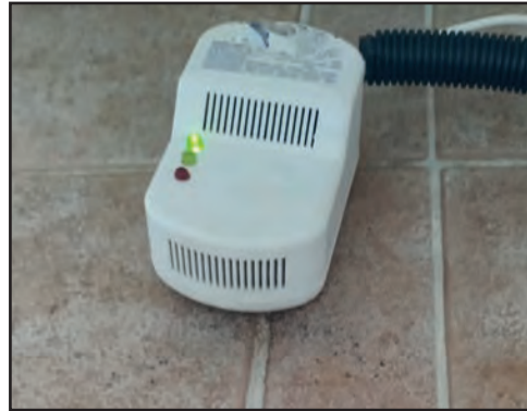
Görsel 1.17: Yangın alarm paneline bağlı olmayan gaz dedektörü
