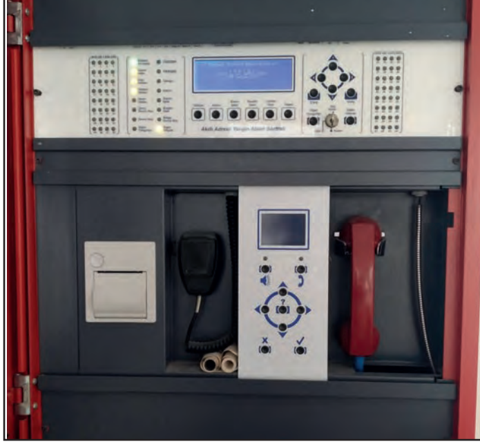
Görsel 1.15: Yangın alarm panelleri
