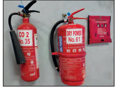
Görsel 1.9: Karbondioksit yangın tüpü
