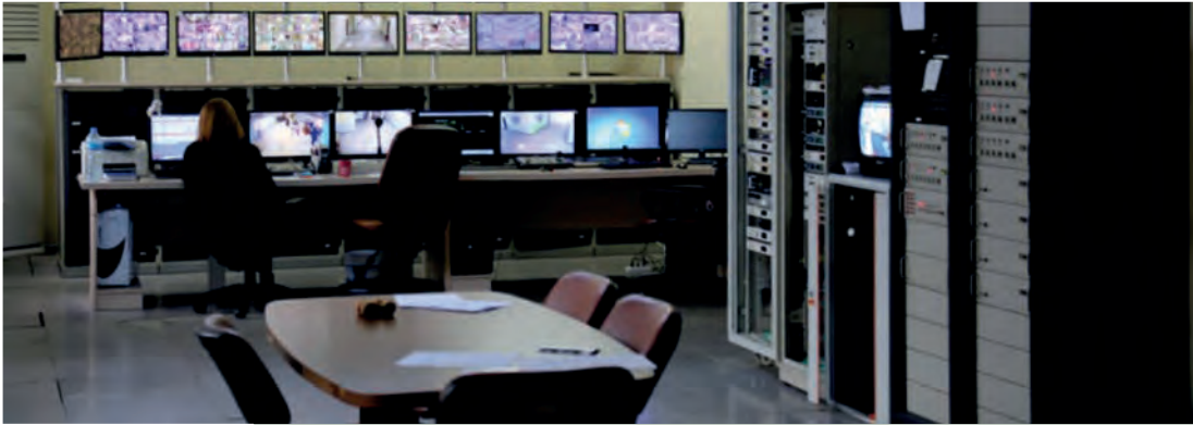
Görsel 2.14 : Bakırköy Açık Cezaevi kontrol merkezi
